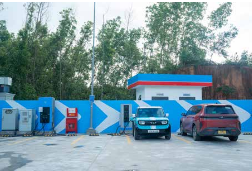
Khu vực trạm sạc dành cho xe điện tại Trạm dừng nghỉ xăng dầu Phú Bình.
